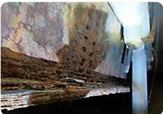
Pont de Triel-sur-Seine, éléments corrodés.
