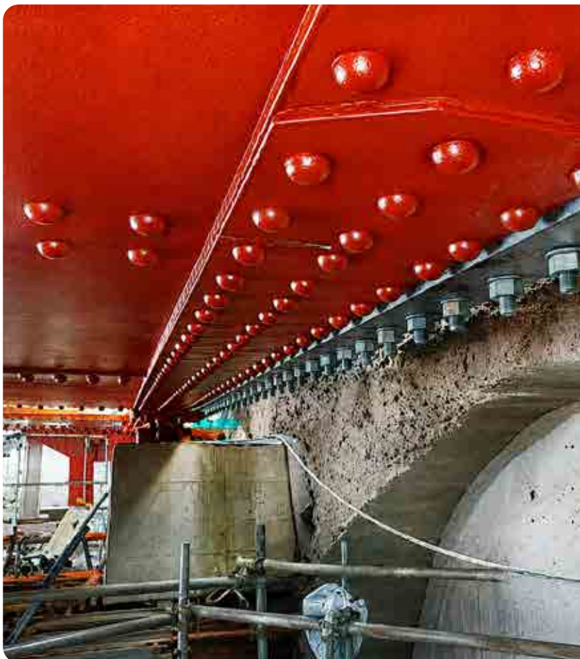
Pont de Triel-sur-Seine, éléments corrodés.
